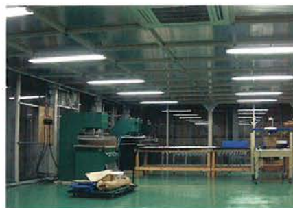
空調機付クリーンブース
