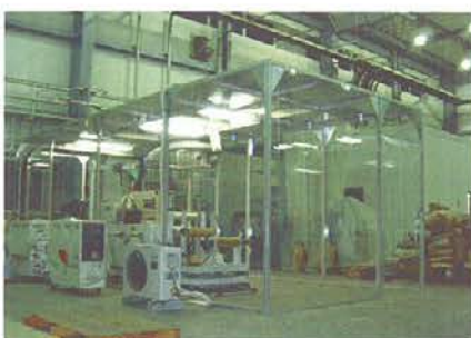
空調機付クリーンブース
