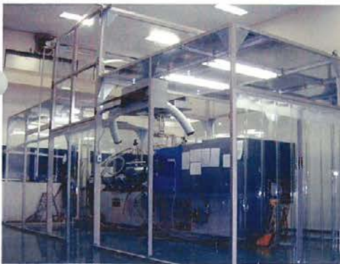
空調機付クリーンブース
